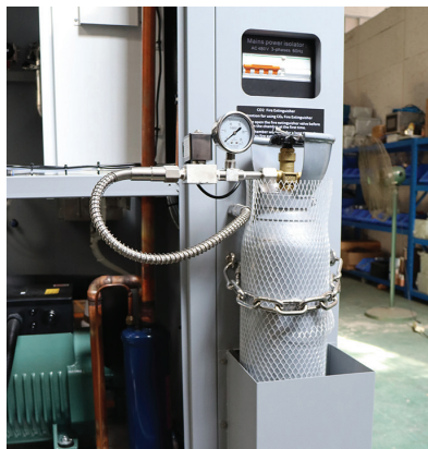
CO 2 fire suppression
